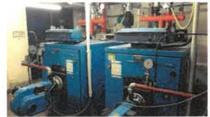
Abb. 1: Heizkessel am Standort Dresden
